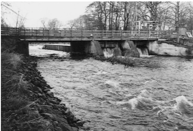
Relleno y esclusa vistos desde el estanque de descanso inferior del relleno, mirando aguas arriba.
