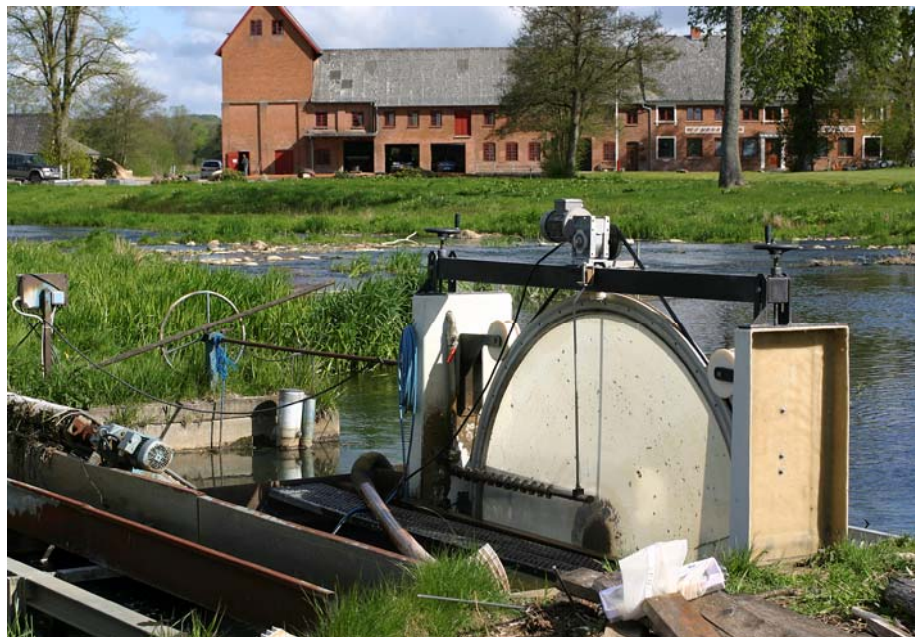
Figur 2.7 Faunasigten i indløbet til Løjstrup Dambrug. Det store roterende hjul er dækket med 1 mm filterdug. Dyrene hænger fast på dugen, mens de drejer en halv omgang med hjulet. Herefter skylles med en vandstråle ned i en rende, hvorfra de føres videre over til et omløb af dambruget. I baggrunden ses det nyetablerede stryg
