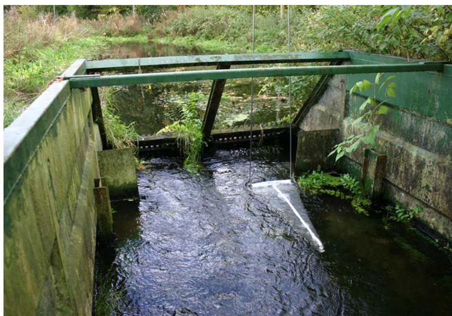
Figur 2.6 Egelund Dambrug ved Lundgårds Bæk. Afløbet fra dambruget sker gennem en container. Det første ud af tre driftnet er anbragt i udløbet. (billede 025)
