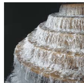
En iltningstrappe i et vandværk sørger for, at indholdet af ilt øges i det oppumpede grundvand inden det bruges som drikkevand.
