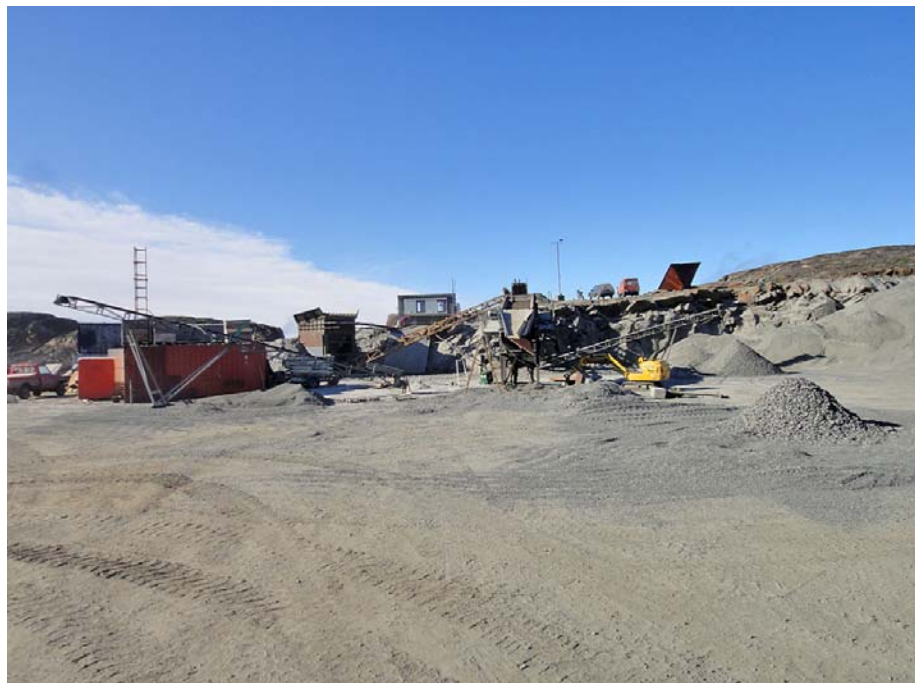
Figur 10. Knuse- og sigteanlæg ved Sisimiut.
